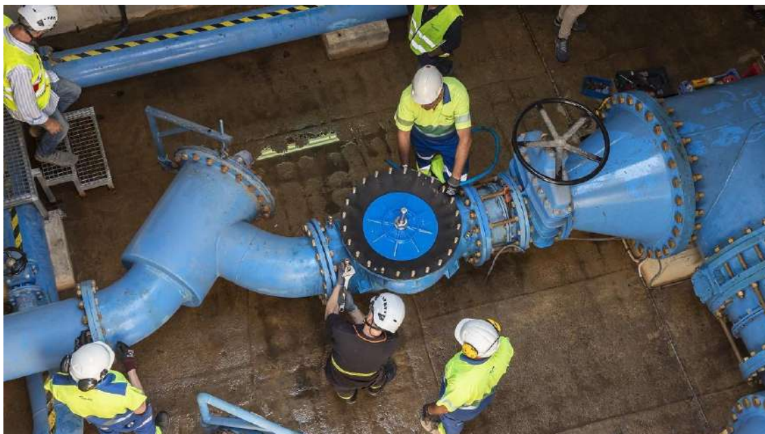
Instalaciones de infraestructuras de agua del grupo Aqualia. / Aqualia
