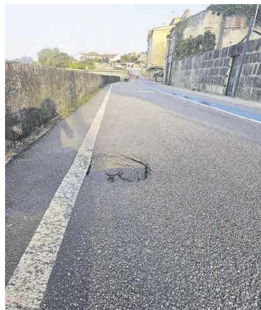
Nuevo hundimiento, ayer, en el vial de O Con. | G.N.
